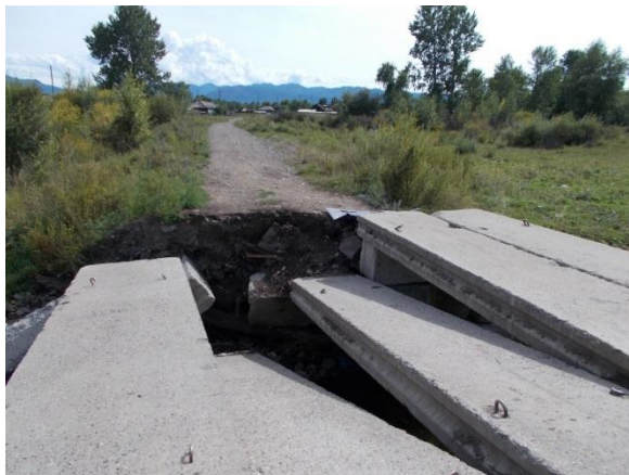
Рис. 3.12. Разрушенный мост через протоку р. Элегест (с. Элегест)
