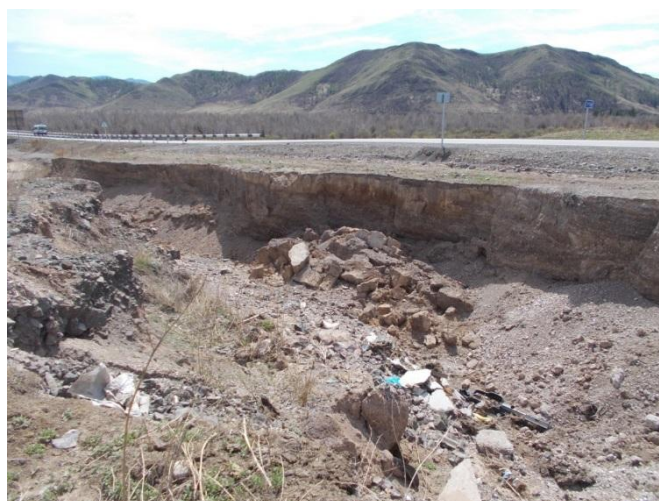
Рис. 3.8. Процессы оврагообразования на Уюкском участке (участок федеральной трассы Р-257 в районе с. Уюк Пий-Хемского района)
